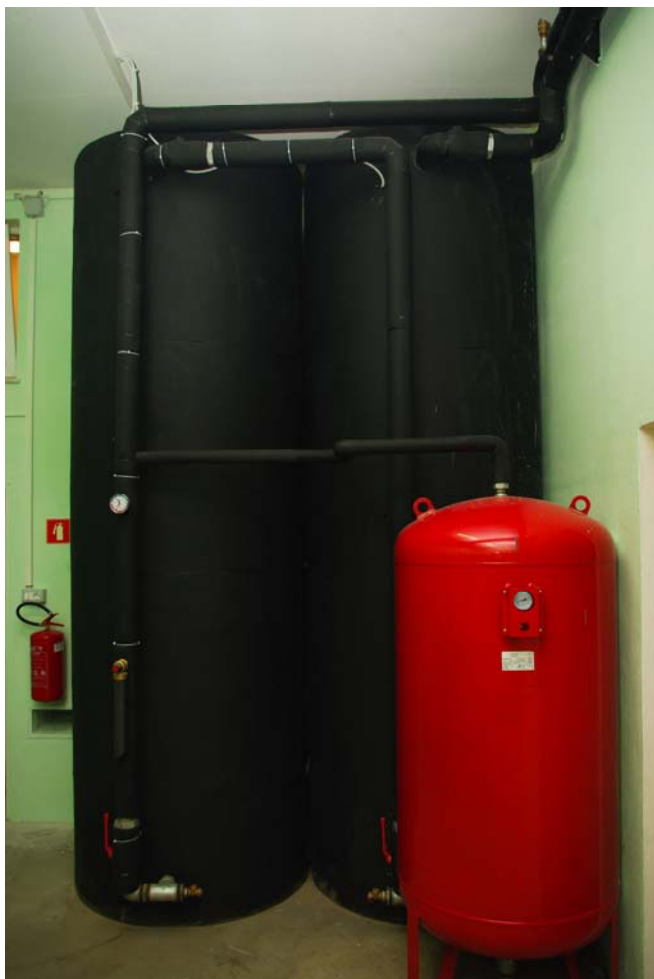
Akumulatorja toplote po 3400 litrov.
